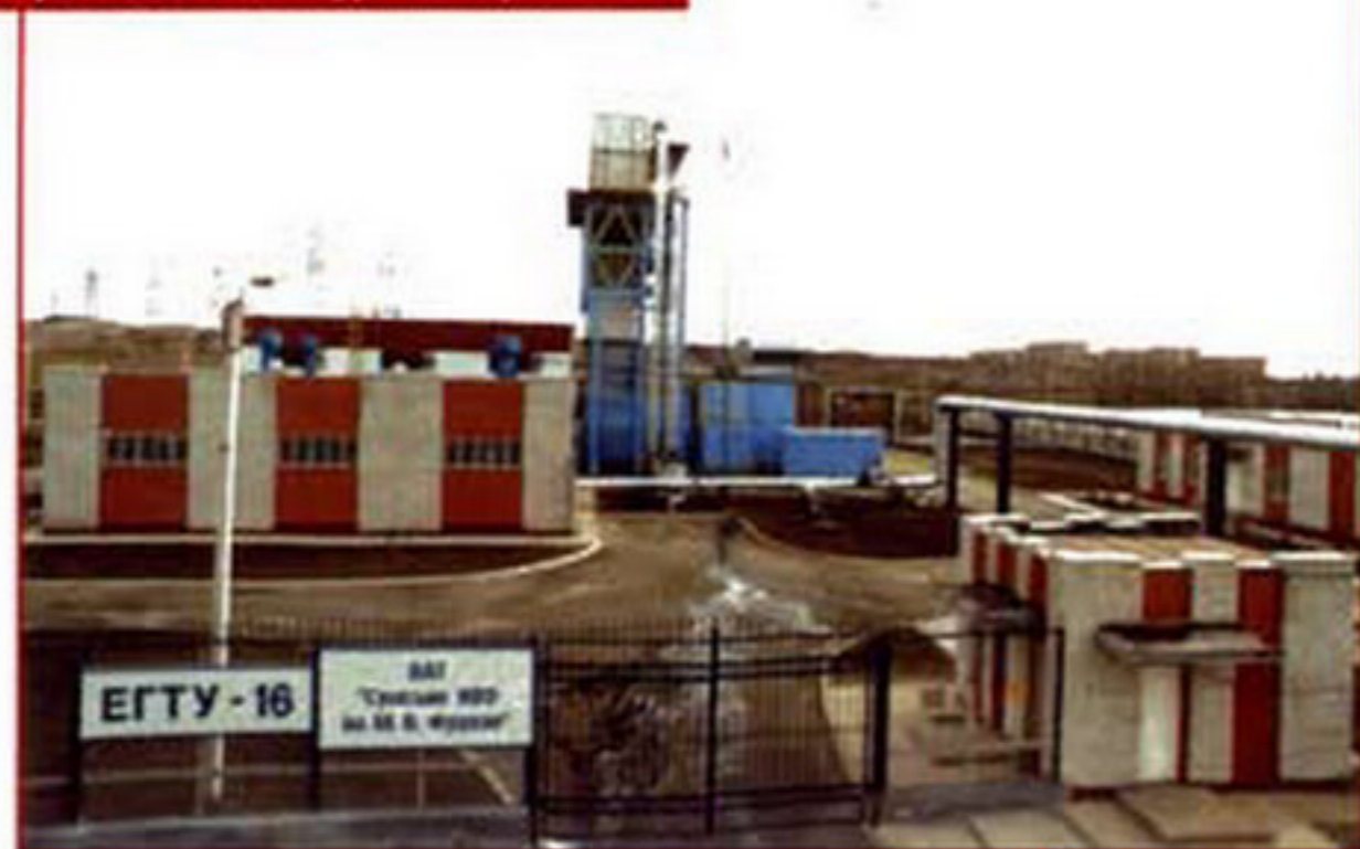
Энергетическая газотурбинная установка
